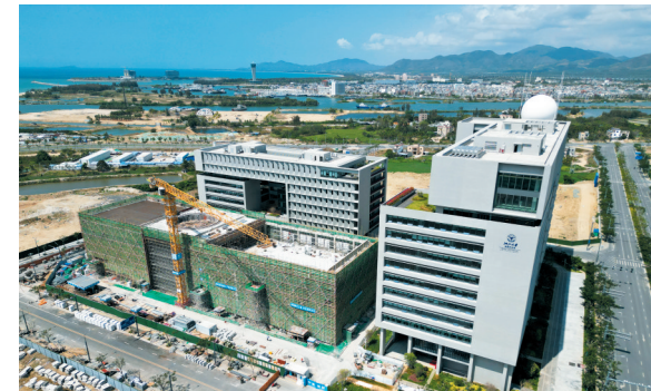
浙江大学(海南)先进技术与产业创新平台建设项目，正在进行砌筑抹灰、幕墙工程及机电安装。
