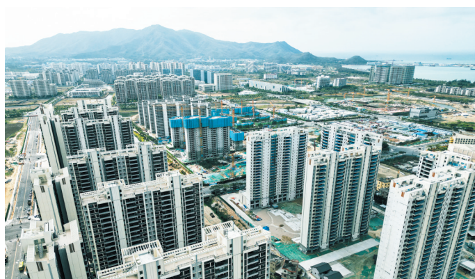
深海科技城安置区(二期)项目一标段，目前正处于装饰装修施工阶段。
