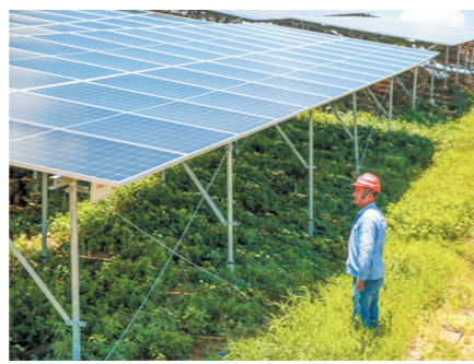
工作人员查看光伏板运行情况。 本报记者 刘琪 摄
