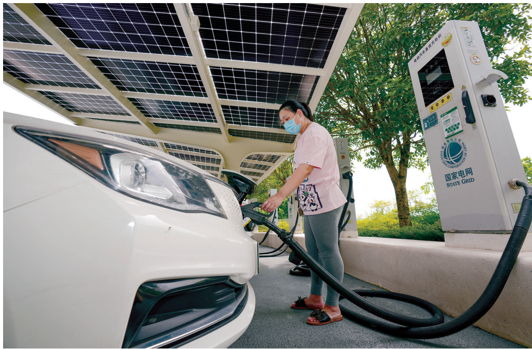
6月16日,在重庆首座光伏充换电一体充电站内,一名女士为新能源汽车充电。新华社记者 刘潺 摄
