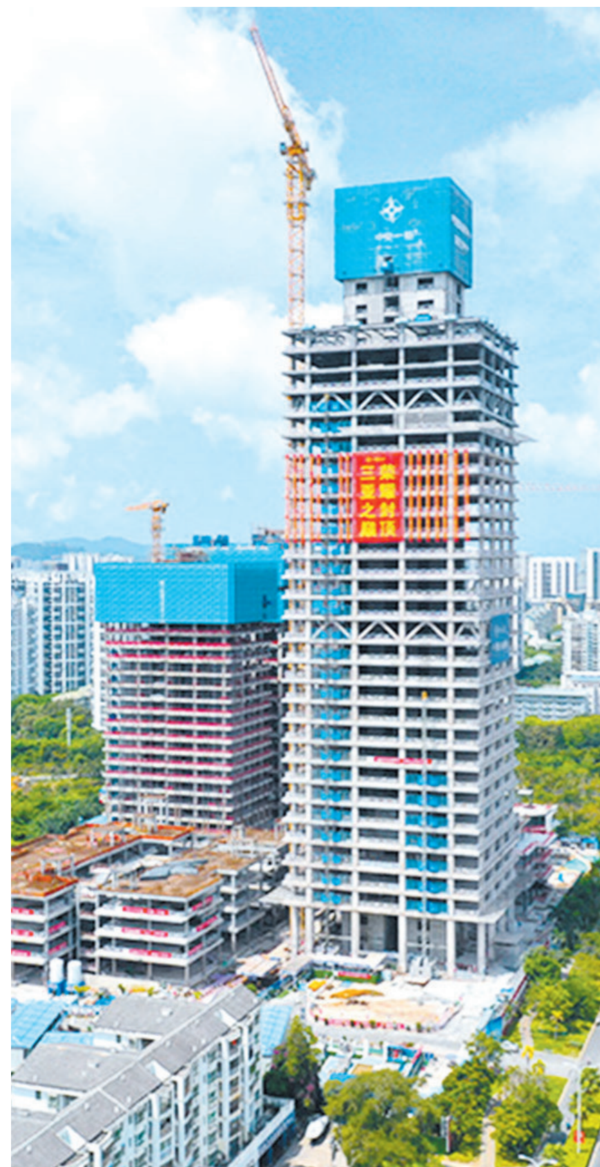
平地高楼 | 5月26日,位于三亚中央商务区的中交海南总部基地项目B地块项目主楼核心筒封顶,标志着工程建设取得了阶段性进展。
