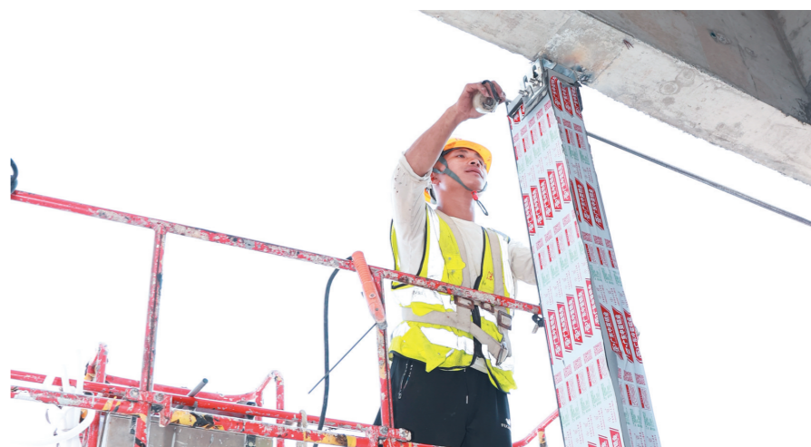
飞檐走壁 | 三亚保利国际广场项目工地,施工人员在安装幕墙钢架。
