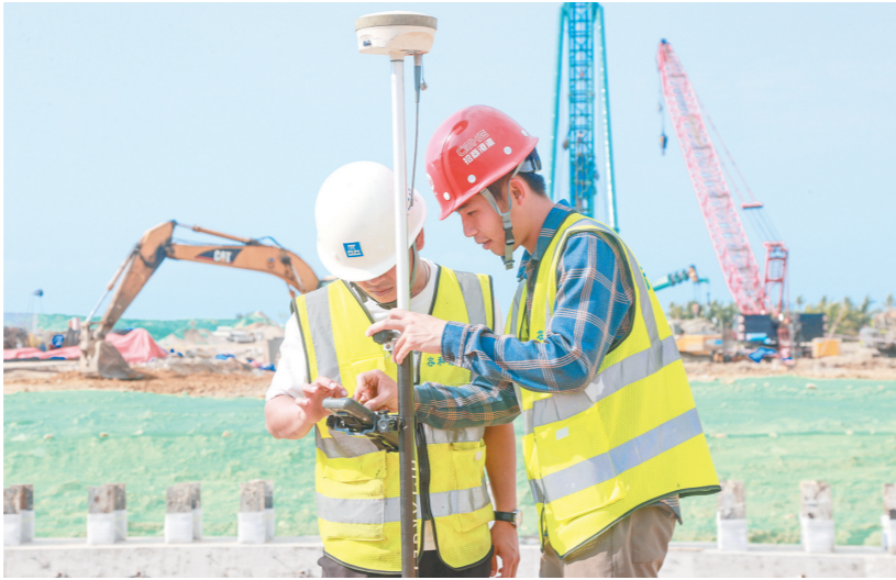
2月7日,浙江大学(海南)先进技术与产业创新平台建设项目工地,工作人员正在测量桩位放样。本报记者 陈聪聪 摄
