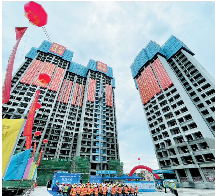
6月11日,位于崖州湾科技城的崖州湾大学城安置区一期项目首批楼栋顺利封顶。 本报记者 李学仕 摄
