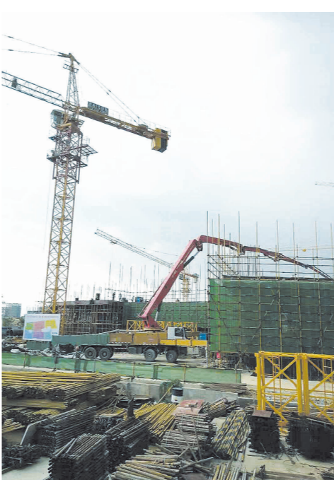
居然之家三亚生活广场项目(一期)施工现场。 本报记者 李劲松 摄
