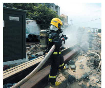
消防官兵用水枪对泄露点进行稀释。本报记者 洪光越 摄
