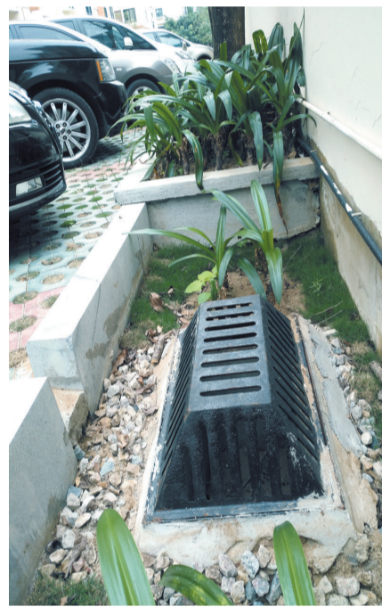
晴竹园小区海绵化改造的透水设施。 本报记者 赵庆山 摄
