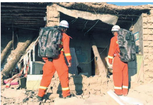
8月9日,新疆博尔塔拉州精河县消防官兵在排查一处坍塌的土坯房。 新华社发
